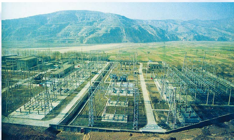
■ 图为330kV变电站全貌
